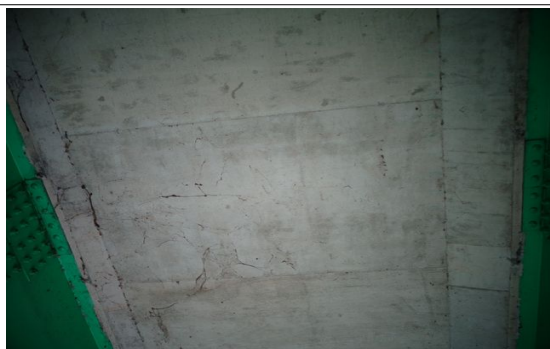
S31 폭 0.3mm미만 균열 (양평방향)
