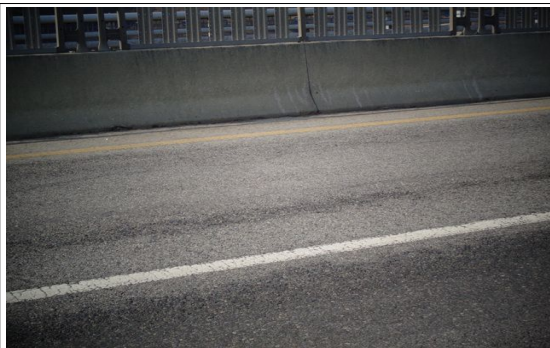
S9 아스콘 균열 (양평방향)
