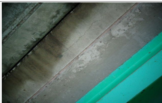
S27 폭 0.3mm이상 균열 (양평방향)
