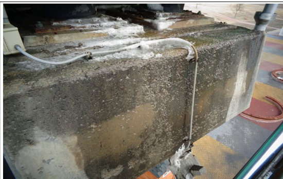
P11 누수흔적 (원주방향)
