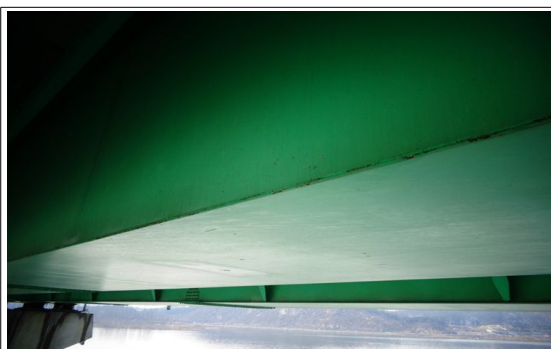
S26 부식 및 도장박리 (원주방향)
