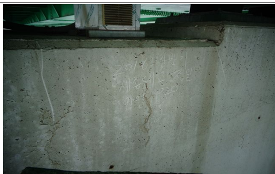
P20 코핑부 0.3mm미만 균열 (양평방향)
