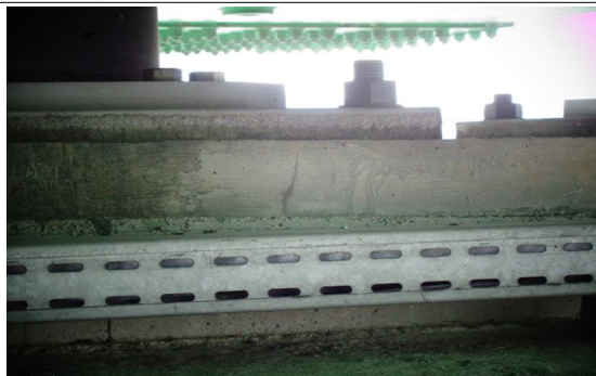
P23-SH1 무수축물탈 균열 (원주방향)
